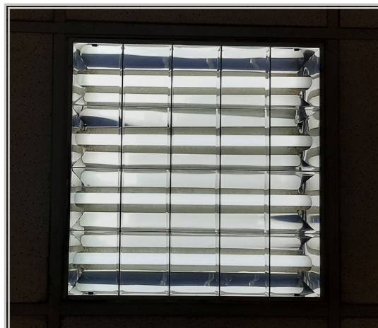
Figura 22. Luminarias de las oficinas en la RNEC
