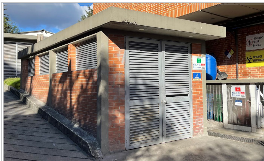
Figura 17. Cuarto de residuos
